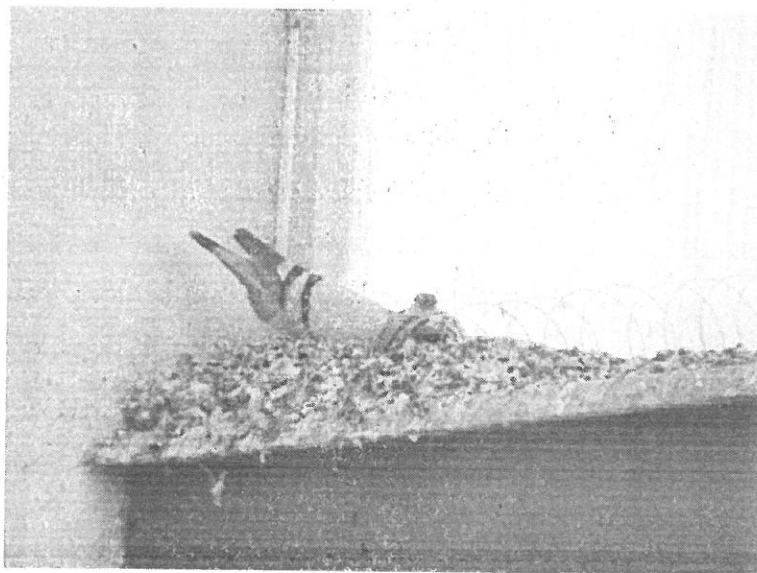
Fot. 2 Gniazdo gołębia miejskiego we wnętrzu łącznika budynku przy ul. Bolesława Krzywoustego 23 oraz nagromadzone odchody w miejscach regularnego przebywania ptaków.
