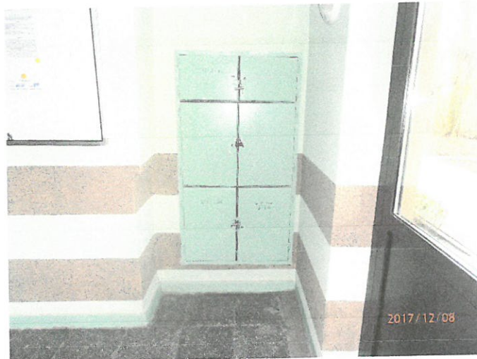
Zdj.nr 1.Widok na główna rozdzielnice w budynku.
