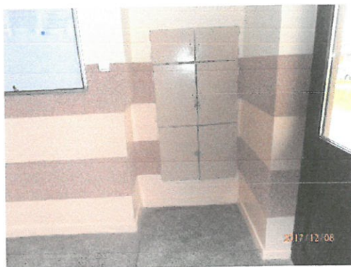
Zdjęcie nr 2. Rozdzielnica prądowa w budynku nr 82.
