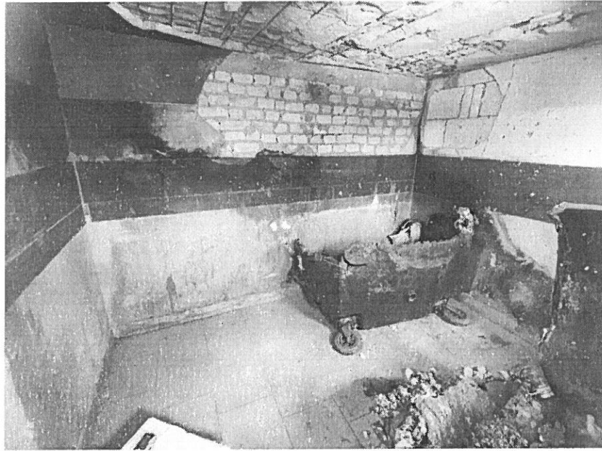
Fot. 3 Widok z pomieszczenia, które uległo spaleniu.
