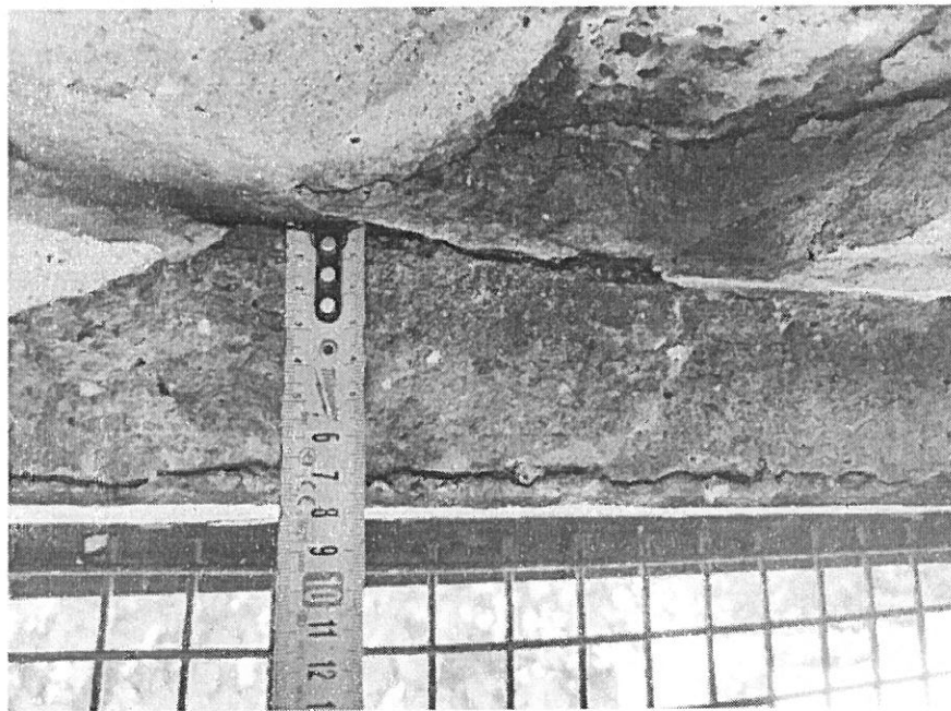
Fot. 6 Widok na nadproże okienne, pomieszczenia w którym miał miejsce pożar.
