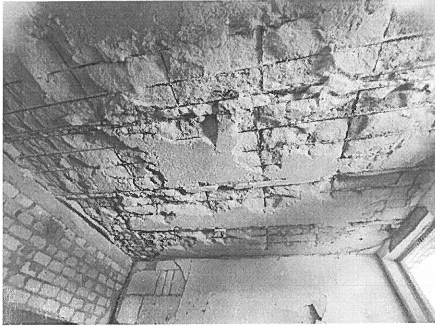
Fot. 5 Widok na uszkodzony spong stropodachu wiaty
